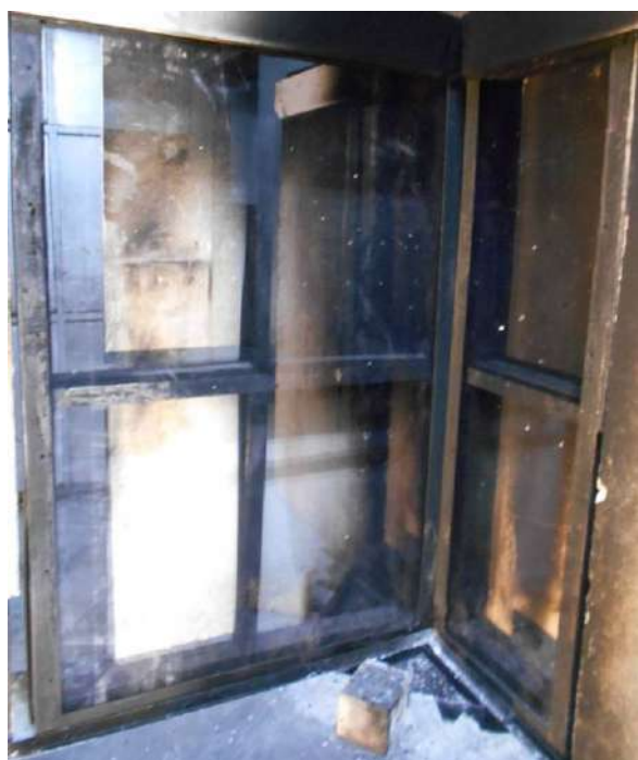
Photographie n° 3- Détail du bord latéral de l'échantillon T3811Y
